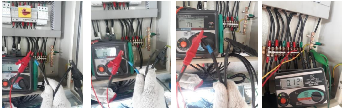
ภาพที่ 5 (ก) สายไฟ DC (Group 1) วัดสาย + , วัดที่ 1,000 Vdc ได้ค่า OL MΩ (ข) สายไฟ DC (Group 2) วัดสาย + , - วัดที่ 1,000 Vdc ได้ค่า OL MΩ (ค) สายไฟ AC วัดสาย + , - วัดที่ 500 Vdc ได้ค่า OL MΩ และ (ง) หลักดินตู้ DB วัดค่าได้ 0.12Ω (ค่าต้องไม่มากกว่า 5 Ω)
