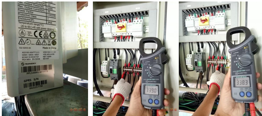
ภาพที่ 6 (ก) Inverter ขนาด 5.0 kW และ (ข) ค่า Vdc ของแผงเซลล์แสงอาทิตย์ (> 80% ของการออกแบบ)
